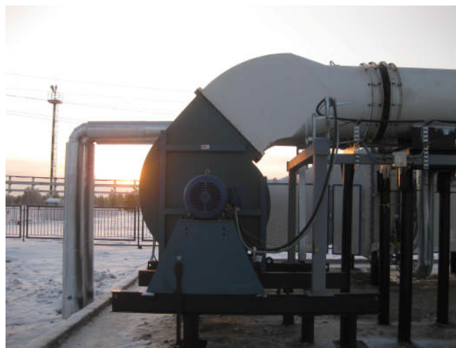
Фото 4. Центробежная воздуходувка печи дожига.
